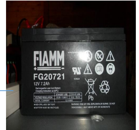
Batteria che alimenta l'ascensore
