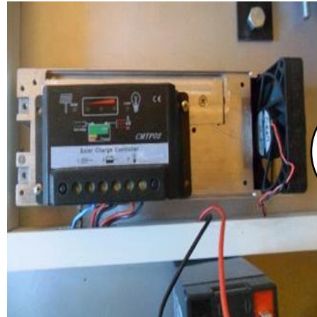
Regolatore di carica con ventole di raffreddamento
