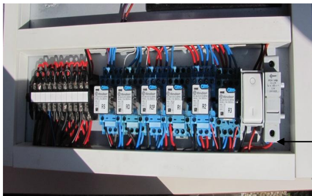
Relè che controllano salita e discesa dell'ascensore
